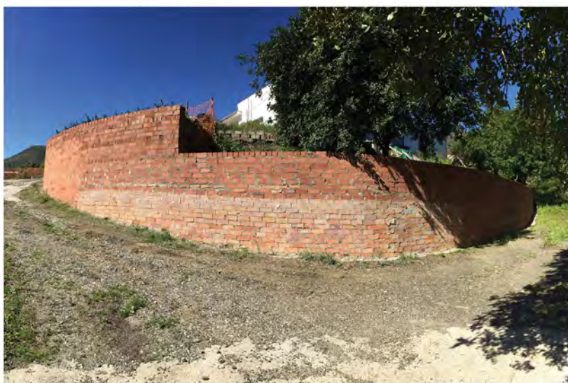
Muro de contención sin tratar.
