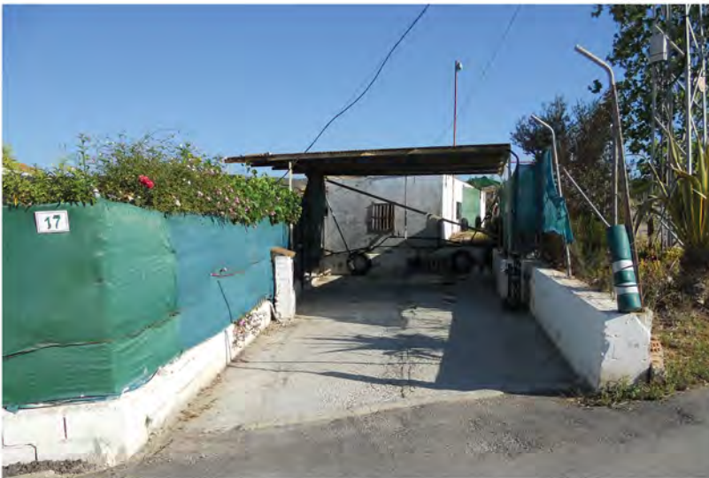
Construcción con vallado fuera normativa y pérgola.
