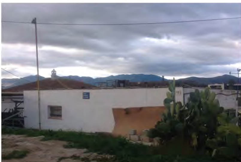
Vivienda con aspecto deteriorado y con pérgola en mal estado.
